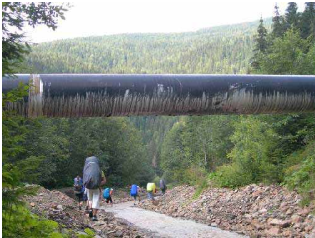
Фото 7.4 – Труба газопроводу нависає над річкою
